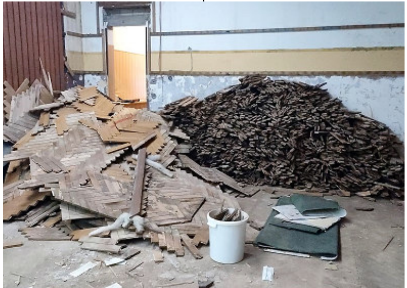
Wasserschaden in der Mehrzweckhalle - Abbruch des Parkettbodens
